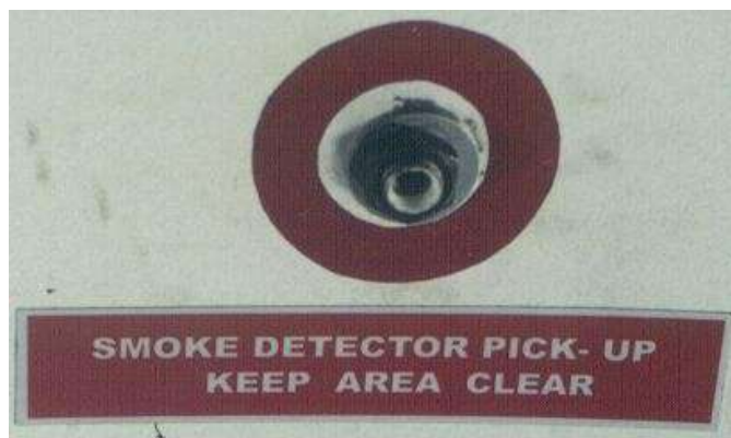
Detector de Fumaça – Porão de Carga de um B 707
